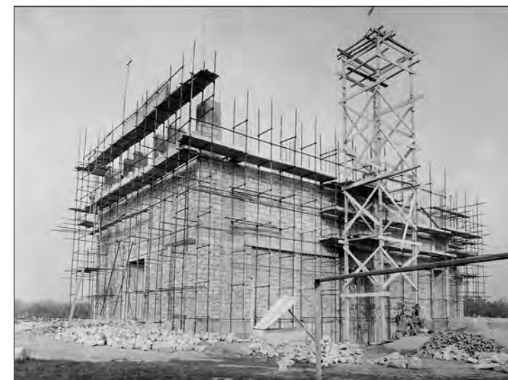
I muri sono arrivati all'altezza di 8 m, mentre i pilastri della facciata sono a quota 12 m.
