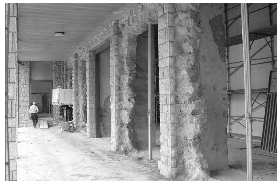
2005, agosto - Abbattimento della parte bassa della parete nord della chiesa per procedere all'ampliamento.
